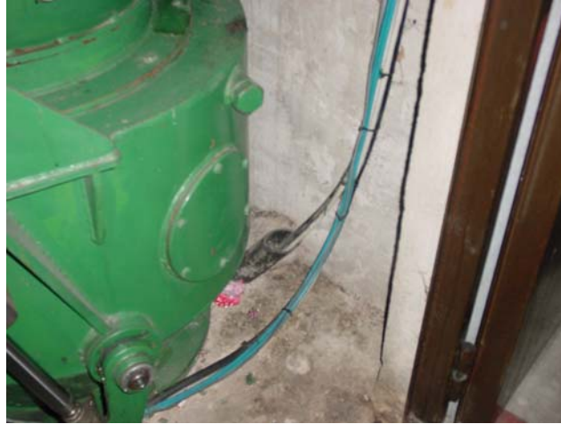
Salida del conducto con el tubo de aire comprimido y el cable de señal.
